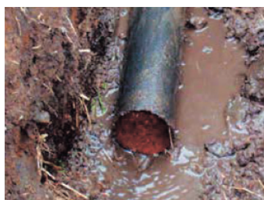
暗渠管内の鉄の集積
