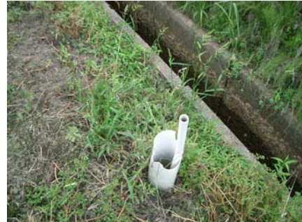
経年変化、雪害等により破損した水閘
